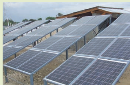
Centrale solaire pour l'éclairage du camp de Santos 17 géré par l'Organisation Internationale des Migrations (OIM).
