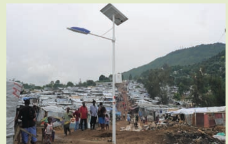
Lampadaire solaire dans le camp de réfugiés de Tapis Rouge.
