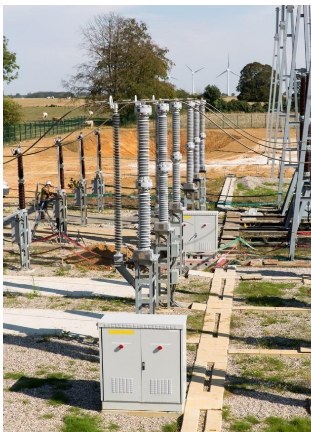
Photo au poste électrique de Blocaux en cours d'installation : en arrière-plan, le contexte éolien, en premier plan : les nouveaux transformateurs de mesure à capteur à base de fibres optiques et leurs armoires de connexion au réseau local informatique industriel de l'ouvrage
