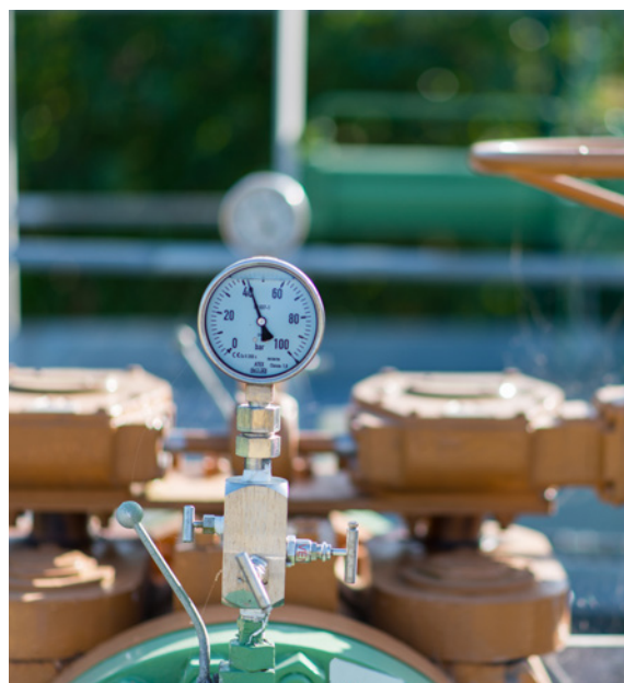
Dispositif de monitoring de la pression sur une installation TIGF.
