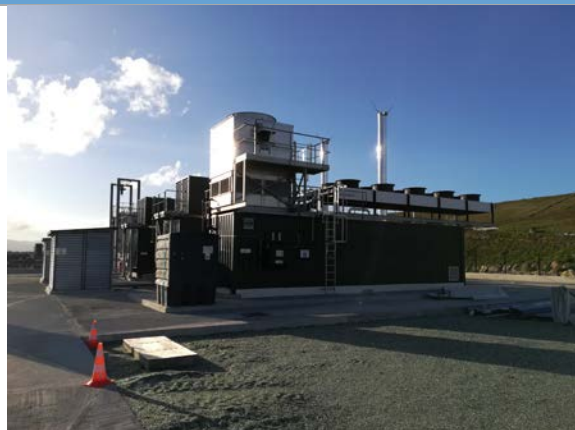
Installation de valorisation du biogaz extrait
